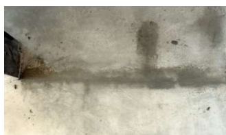
Grieta rellena limpia/sin lijar
